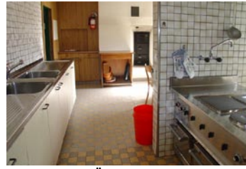
KÜCHE 1.OG Elektroherd mit 5 Platten 2 Backöfen
